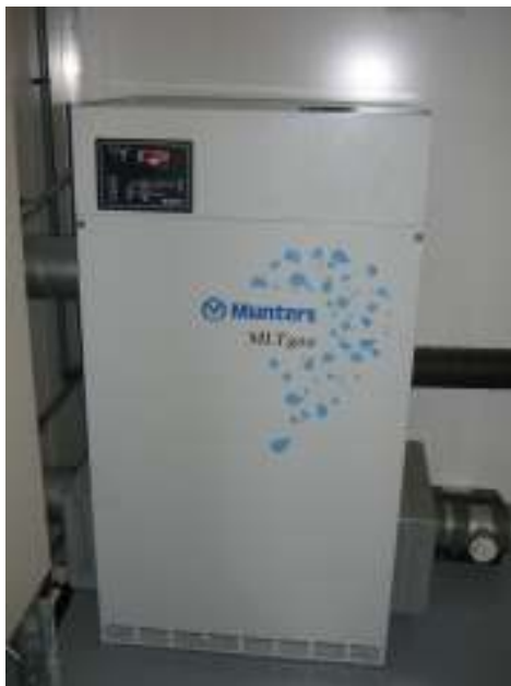
Slika 31. Dehumidifikator Munters MLT 800. Autorska fotografija.
