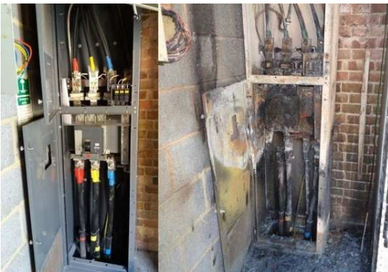
Slika 1. Posljedice električnog luka na električnim instalacijama [1]
