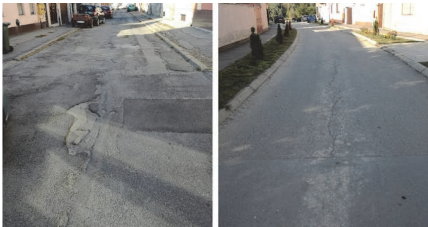
Slika 7. Fotografije postojećeg stanja kolnika: a) Cvjetkova ulica, b) Lađarska ulica
