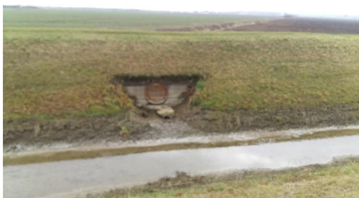
Slika 5.12. Izljev kanala Drobnjak u rijeku Vuku
