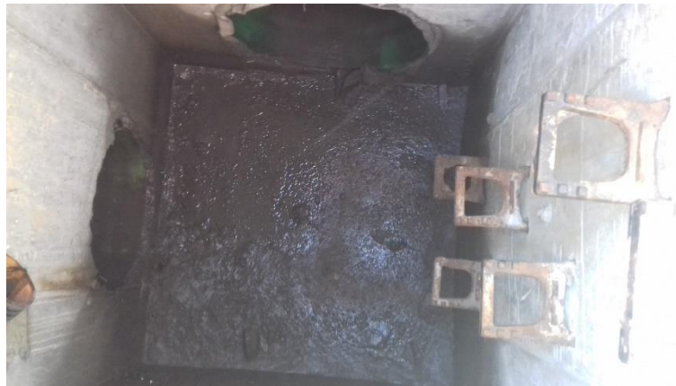
Slika 5.6. Separator Južna obilaznica (18.05.2017)
