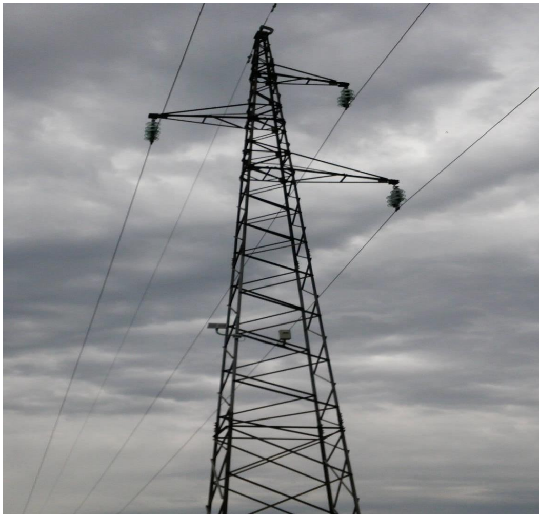
Slika 3.2. Indikator kvara SIK-30 montiran ispod vodiča 35 kV
