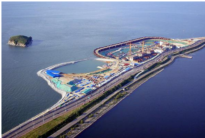
Slika 6.1. Hidroelektrana na plimu i oseku Sihwa
