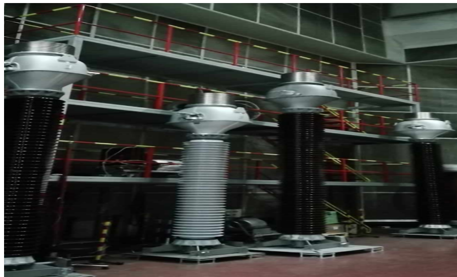
Slika 3.4.: Ispitivanje klase točnosti, ima tri kata, ovisno o visini transformatora tvornice Končar.
