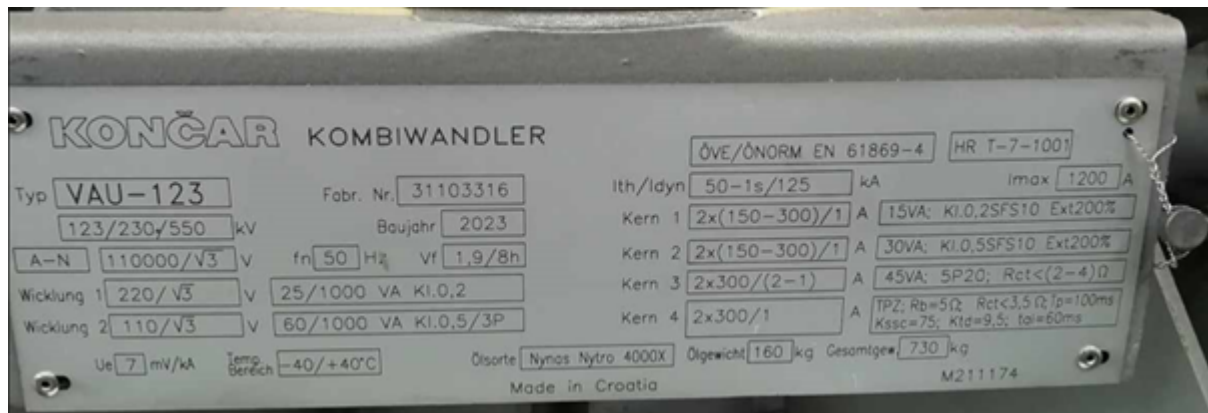
Slika 2.24.: Natpisna pločica kombiniranog mjernog transformatora tvornica Končar.
