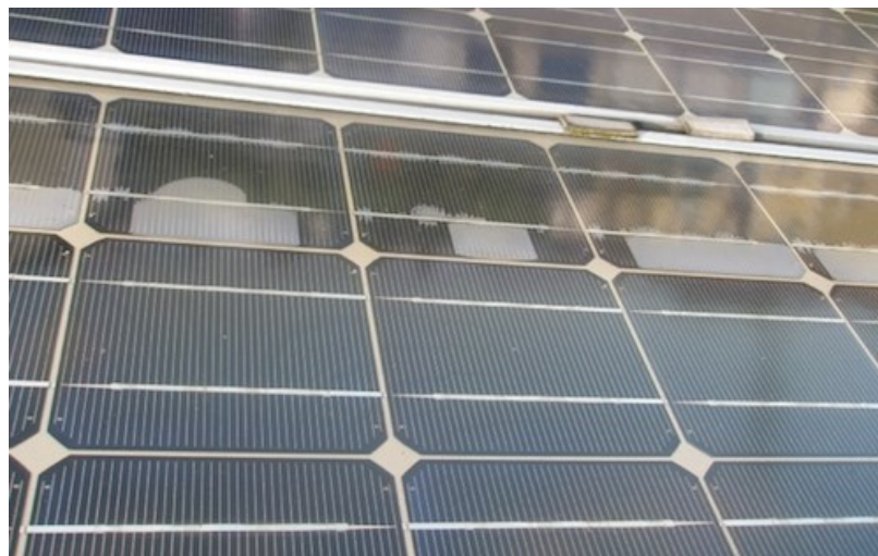
Slika 4.2. Delaminacija c-Si modula [19]
