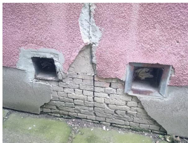
Slika 4.22. Oštećenja na cokolu zidu podruma.
