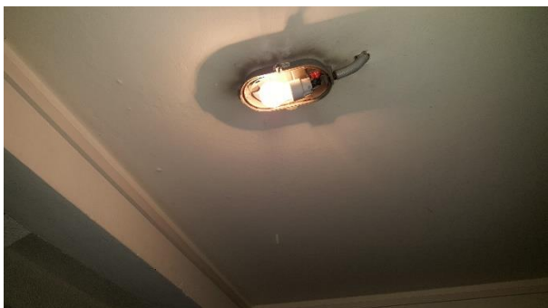
Slika 4.41. Rasvjeta zajedničkog komunikacijskog prostora (stubište).
