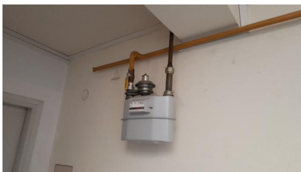
Slika 4.37. Jedan od plinskih priključaka stambenih prostora.
