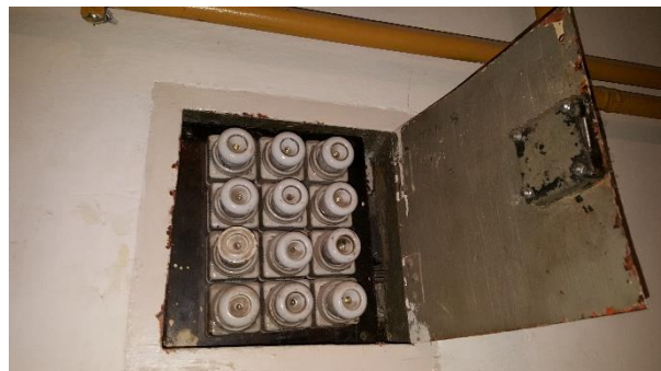
Slika 4.44. Karakteristični etažni razdjelni ormar.
