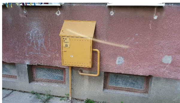
Slika 4.38. Glavni plinski priključni mjerni ormarić zgrade (MRS).
