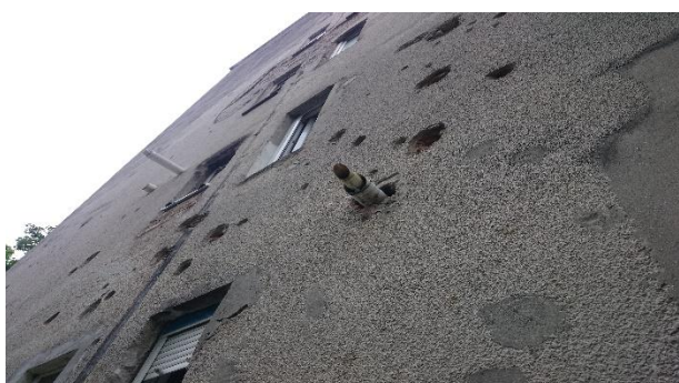
Slika 4.36. Jedan od fasadnih ispuha plinskih kombi bojlera.
