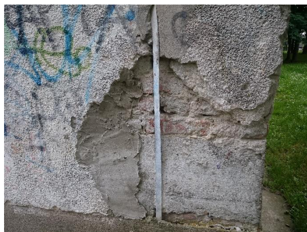
Slika 4.24. Oštećenja na fasadi.
