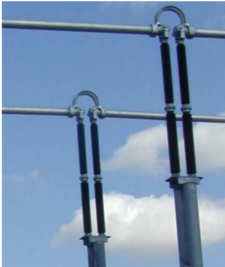
Slika 3.2. Potporni izolator na 400 kV-noj sabirnici [4]
