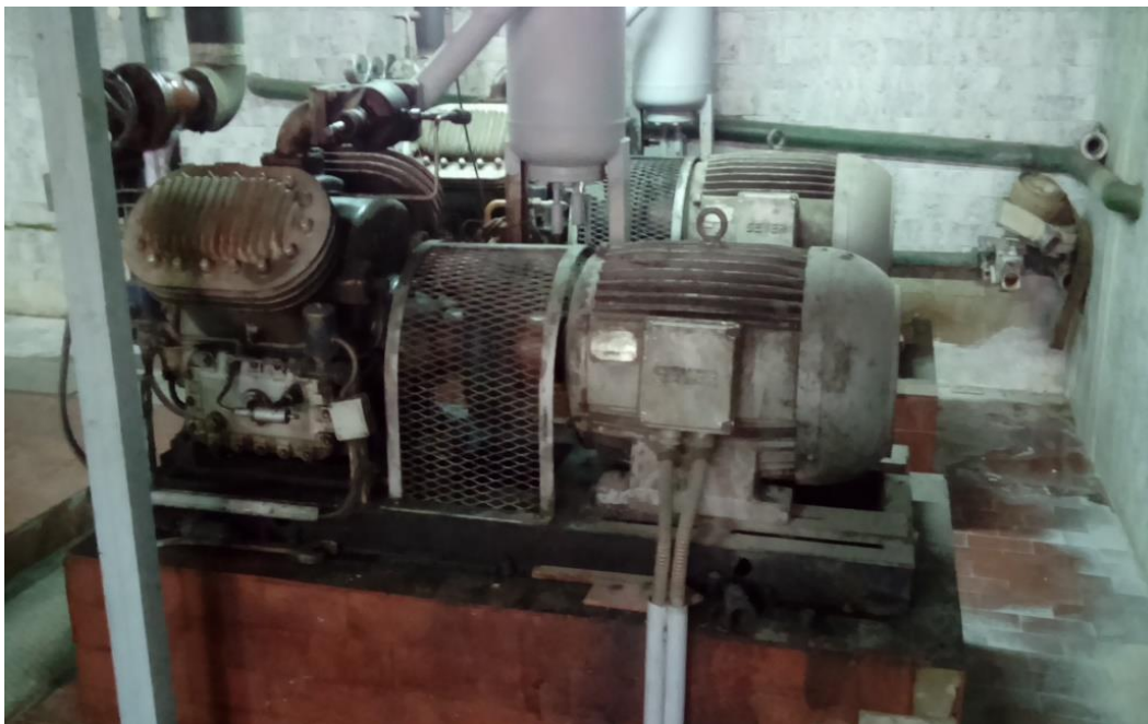
Slika 4.3. Amonijačni rashladni kompresori
