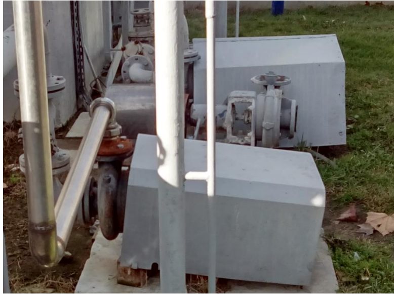
Slika 4.3. Pumpe evaporativnog kondenzatora
