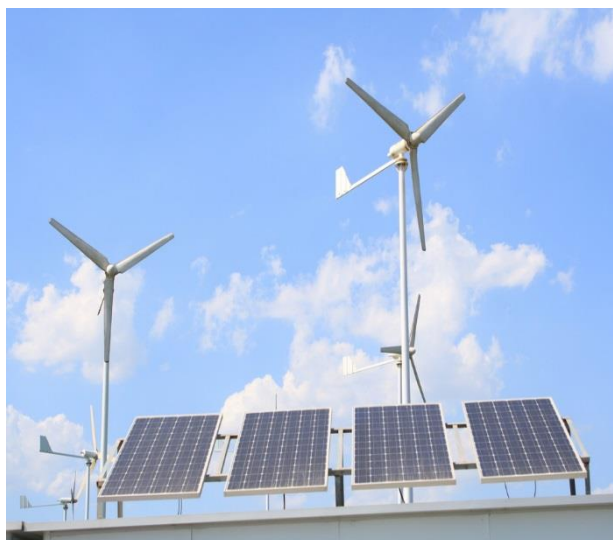
Slika 4.6. Slika prikazuje vjetroelektrane snage 3 kW [31]
