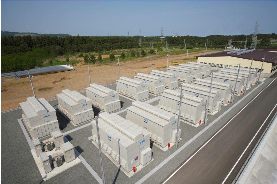
Sl. 2.6. Instalacija Na – S baterija za vjetroelektranu od 51 MW (Rokkasho, Japan) [9]
