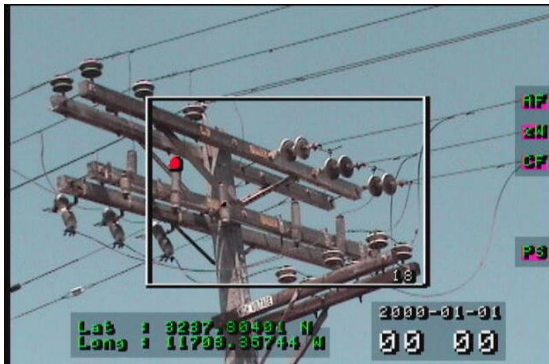
Slika 8.4. Prikaz dalekovoda UV kamerom u vidljivim bojama
