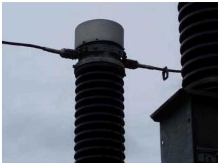
Slika 4.4.7. Termogram strujnog mjernog transformatora u vodnom polju [5]
