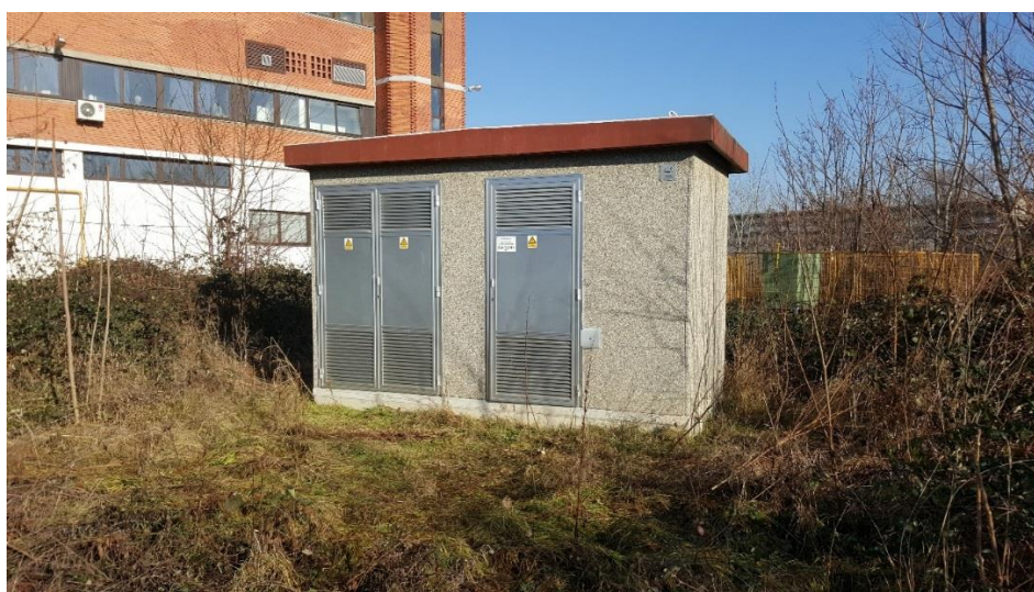
Slika 4.3. Trafostanica KTS Borovo 3, 10(20)/0,4kV, 1000VA na južnoj strani Obučare [2]
