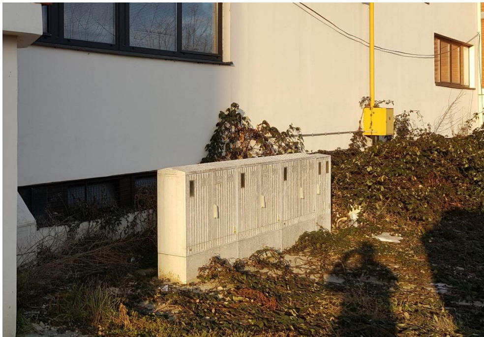
Slika 4.1. Samostojeći mjerni razvodni ormari [2]
