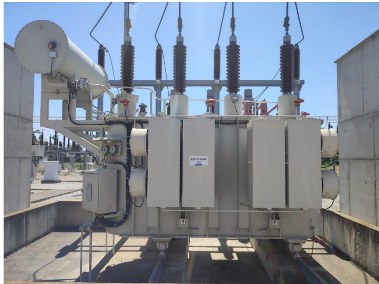
Slika 3.7. Distributivni transformator s automatskom preklopkom (110/20/10 kV) nazivne snage 20000 kVA.
