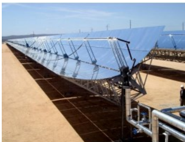
Slika 3.6. Postrojenje s paraboličnim žljebastim kolektorima [7]
