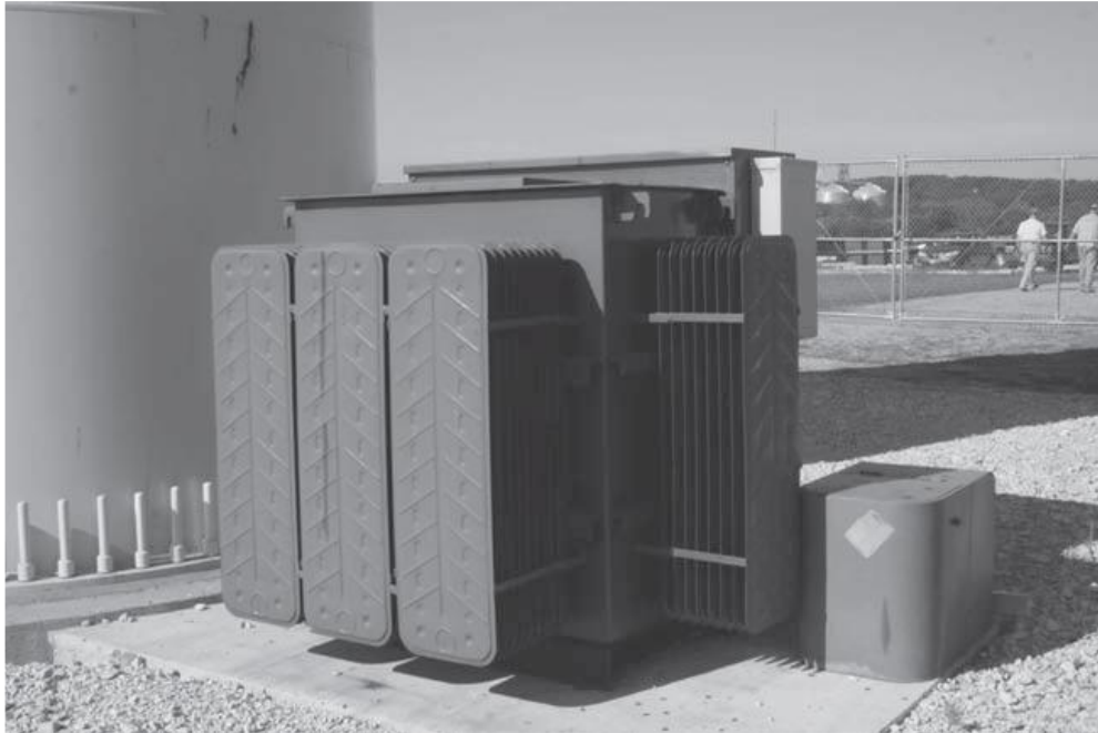
Slika 4.11: Transformator. Preuzeto iz (Hemami, 2012).
