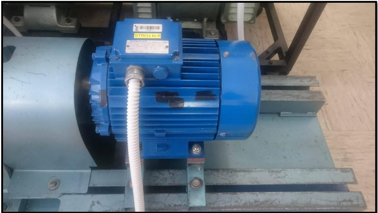
Slika 2.2. Laboratorijski asinkroni kavezni motor
