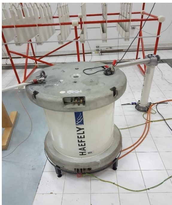
Slika 4.8. VN laboratorijski transformator
