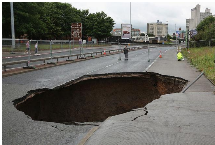
Sl. 2.1. Rupa na cesti nastala erozijom
