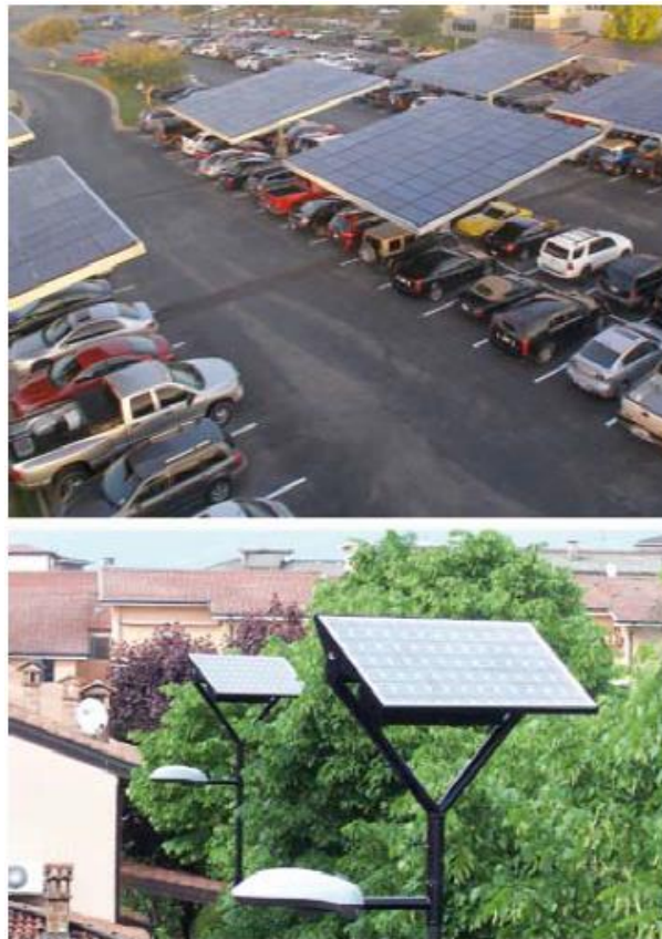
Slika 3.16. Primjeri samostojećih fotonaponskih sustava. [8]
