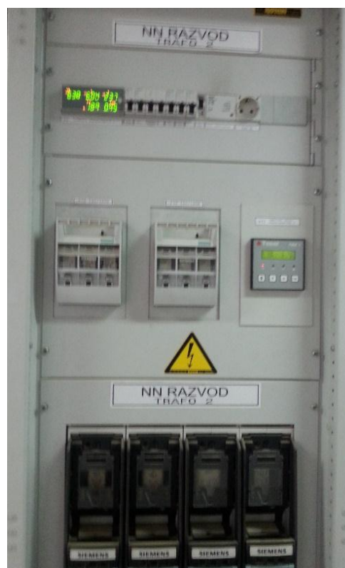
Slika 5.9. Niskonaponski razvod transformator 2
