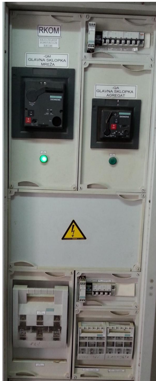
Slika 5.10. Glavna sklopka mreže i pomoćni agregat
