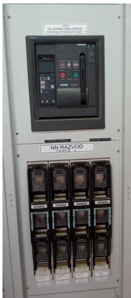
Slika 5.5. Dovodno polje transformator 1
