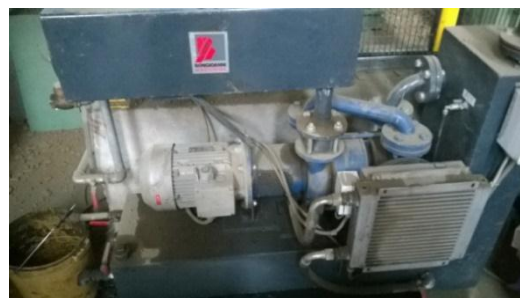
Slika 4.13. asinkroni motor vakuuma pumpe
