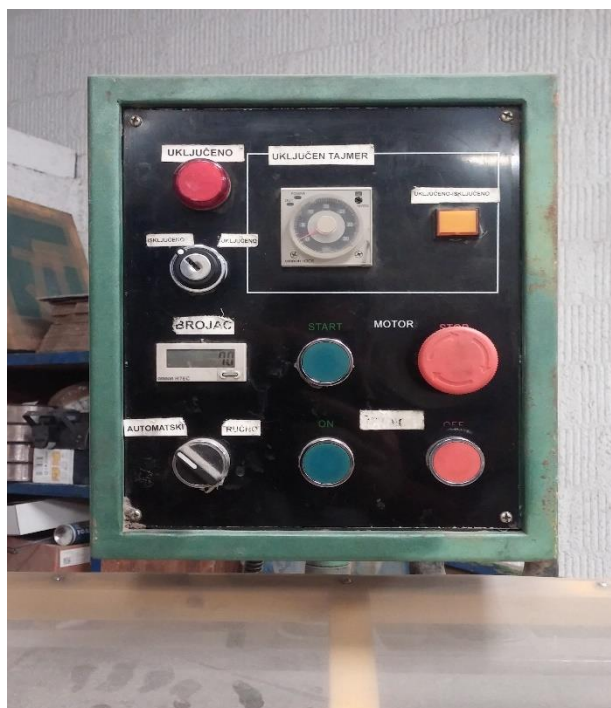
Slika 4.31. Kontrolna kutija zaklopne štanice
