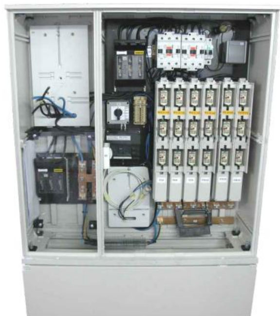
Sl. 3.4 Ormar javne rasvjete, [11].
