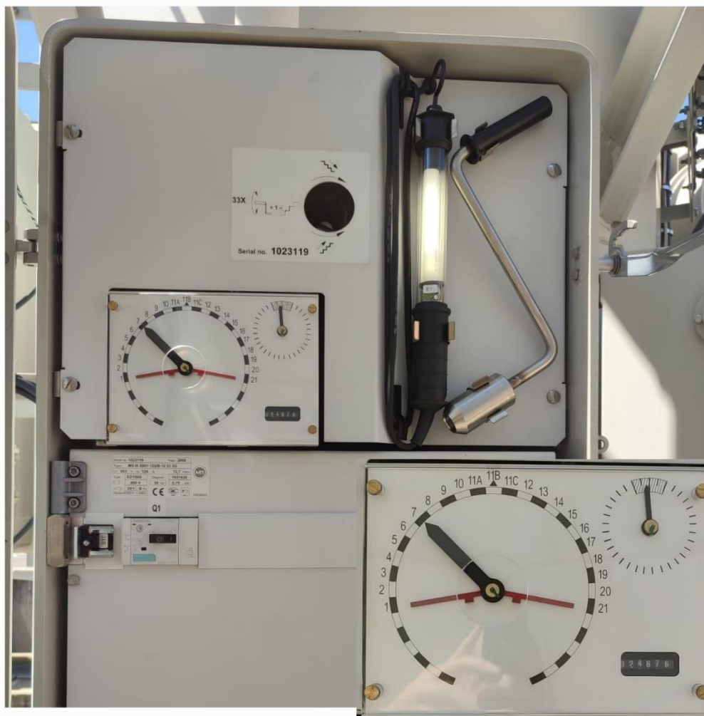
Slika 3.8. Prikaz položaja regulacije distributivnog transformatora s automatskom preklopkom (110/20/10 kV) nazivne snage 20000 kVA.
