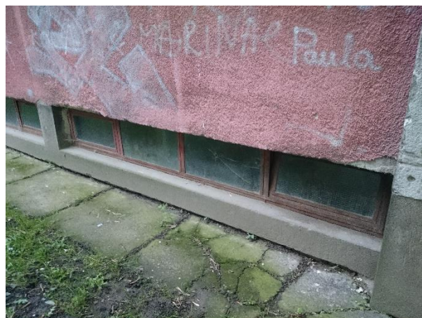
Slika 4.26. Oštećenja na otvorima (prozor podruma).
