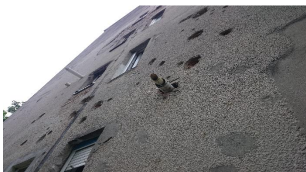
Slika 4.36. Jedan od fasadnih ispuha plinskiх kombi bojlera.
