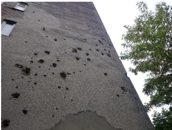
Slika 4.23. Oštećenja na fasadi.
