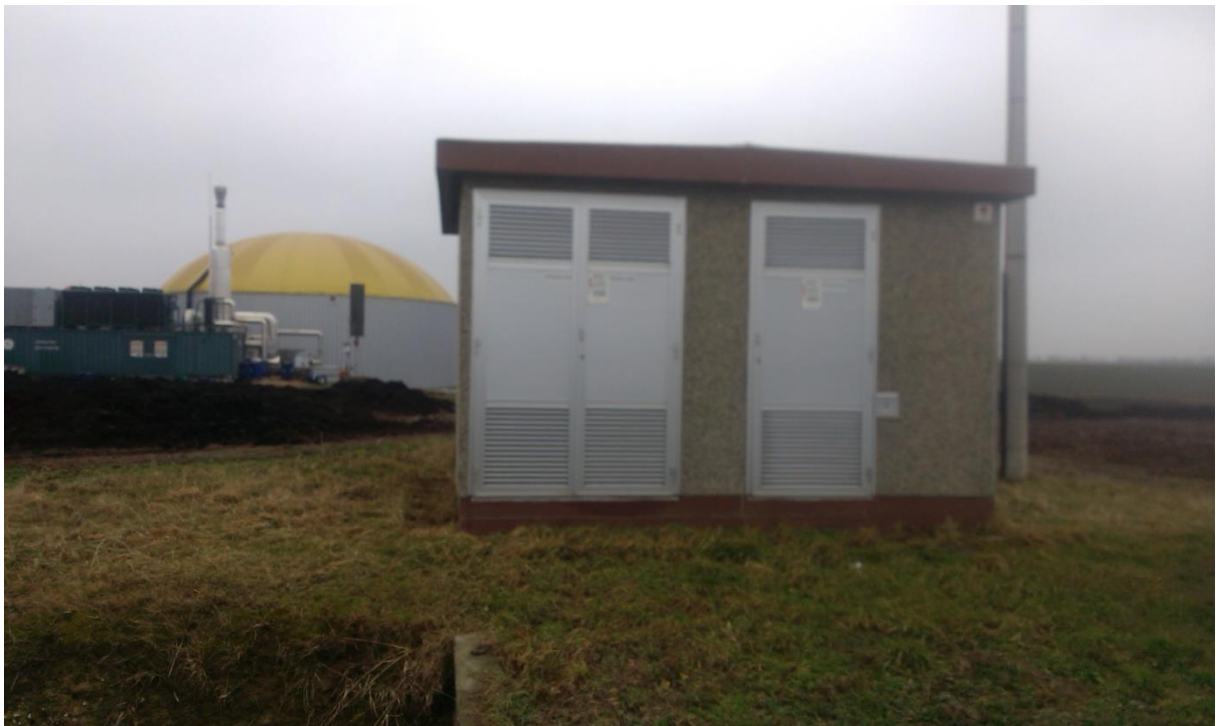
Slika 5.23. Transformatorska stanica HEP-a
