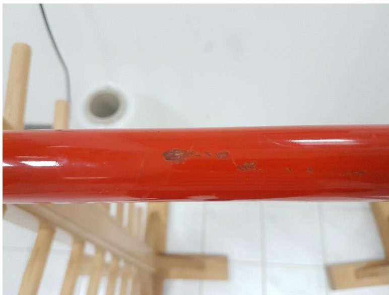
Slika 4.3. Površinsko oštećenje izolacije uzemljivačke motke
