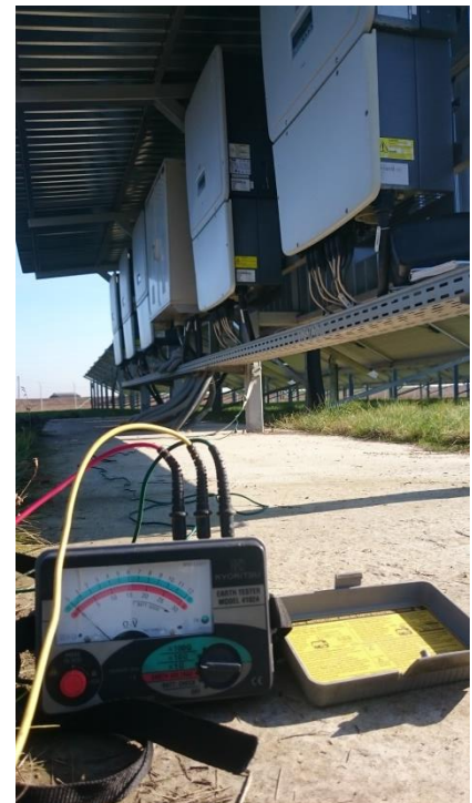
Slika 4.11. Mjerni instrument spojen na grupu invertora 3
