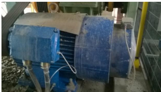
Slika 4.12. asinkroni motor stroja za vakumiranje
